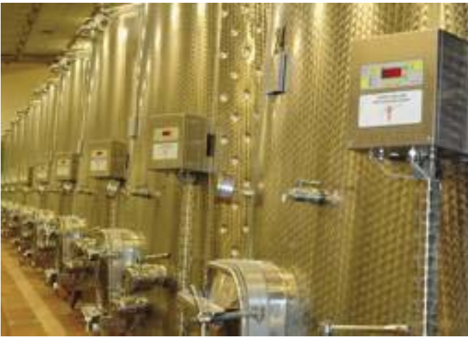
>> Cantina dotata di dispositivi di controllo posti su ogni singolo serbatoio.
