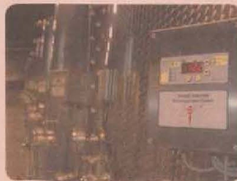
Impianto cantina realizzato con i sistemi Parsec
